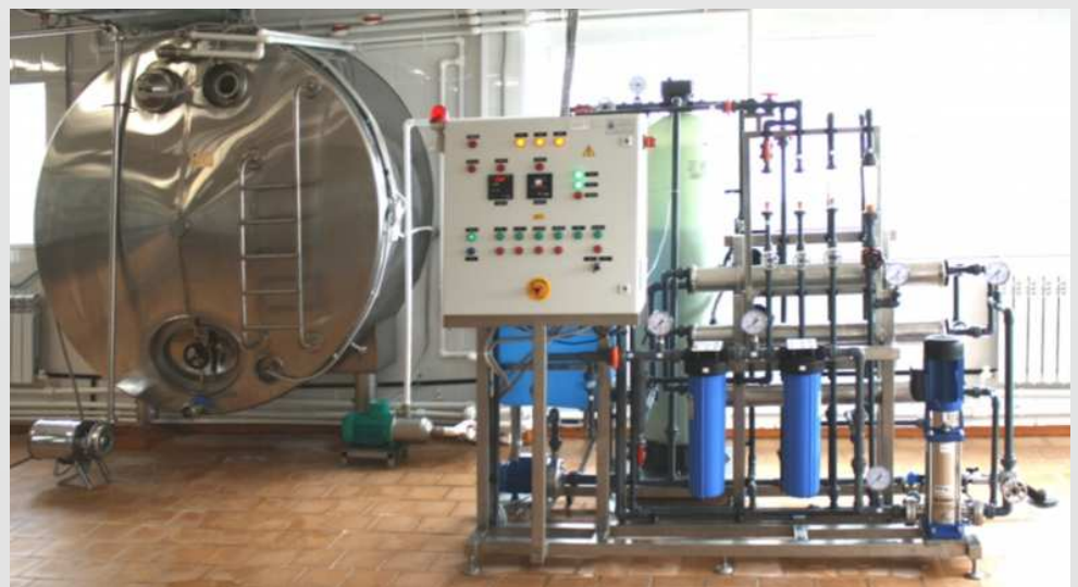
6. Установка марки "ВОДОПАД МЖ 1,0-1-3,95-40-3", 1000 л/ч подготовленной воды для мойки мембранной установки; ЗАО "Сернурский сырзавод"; эксплуатируется с 2015г.
