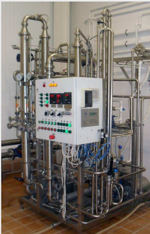
7. Установка марки "ВОДОПАД МТК 6,1-2-20", 150 кг творога в час из коровьего молока; ОАО «Ростагрокомплекс»; эксплуатируется с 2016 г.
